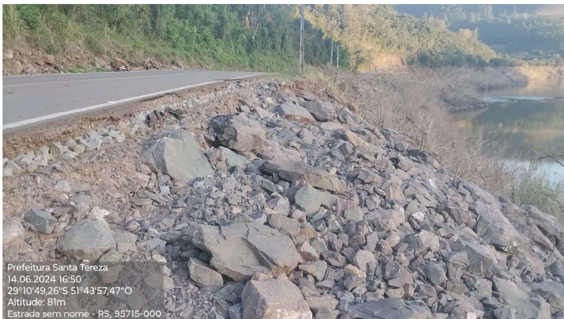
Imagem 04: arrancamento da vegetação, defesa metálica totalmente levada pela água, erosão na lateral da pista necessitando de restabelecimento da saia de apoio ao bordo; Coordenadas: latitude 29°10'49,26\"/>
