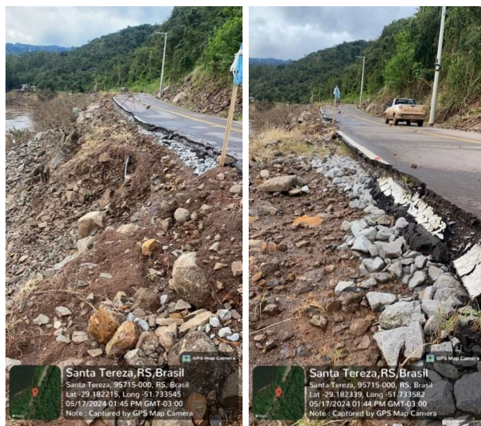
Imagem 16: pista comprometida com avarias nos bordos. Como solução sugere-se reinstalar defensas metálicas arrancadas, construir contenção em pedra para sustentação do bordo e realizar a pavimentação do trecho da pista avariado;
