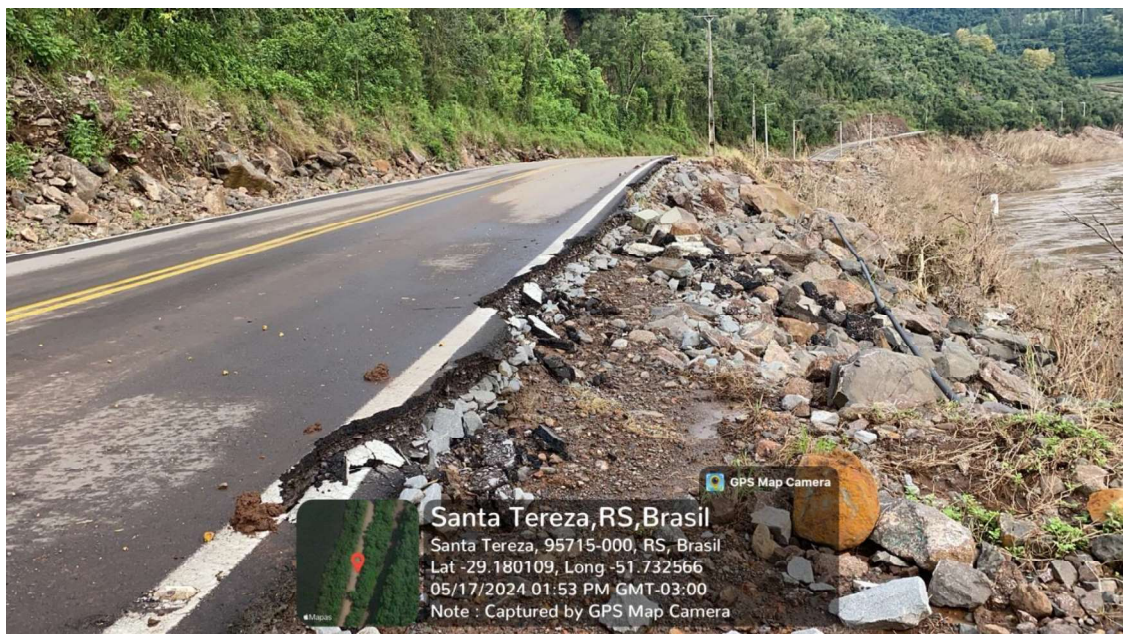
Imagem 03: bordo de pista destruído e aterro da saia da pavimentação erodido comprometendo a segurança da via; Coordenadas: latitude -29.180109° e longitude -51.732566°; Fonte: o autor; Data da imagem: 17 de maio de 2024.
