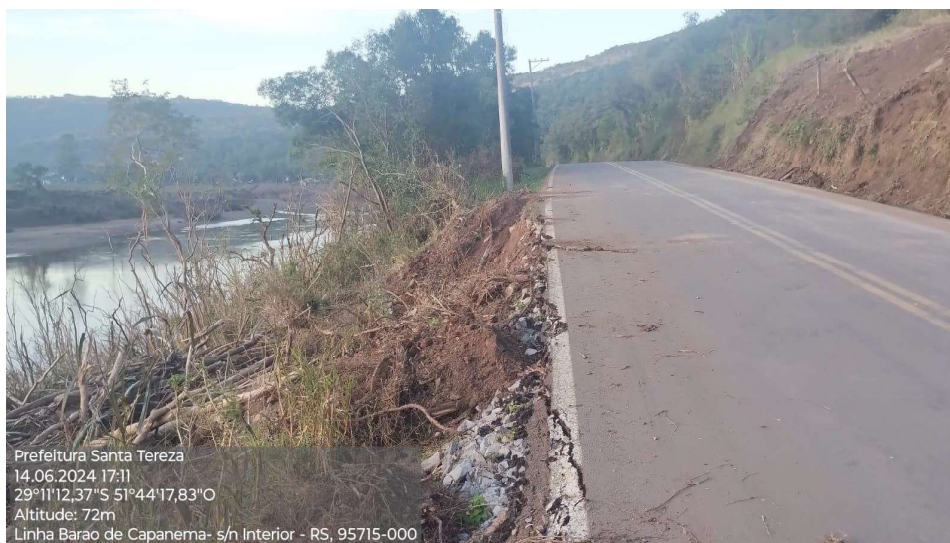
Imagem 33: erosão do talude comprometendo a pista, bordo comprometido, asfalto rachado, risco de colapso do pavimento, necessário contenção com pedras no bordo e restabelecimento do pavimento; Coordenadas: latitude 29°11'12,37"S e longitude 51°44'17,83"O; Fonte: o autor; Data da imagem: 14 de junho de 2024.
