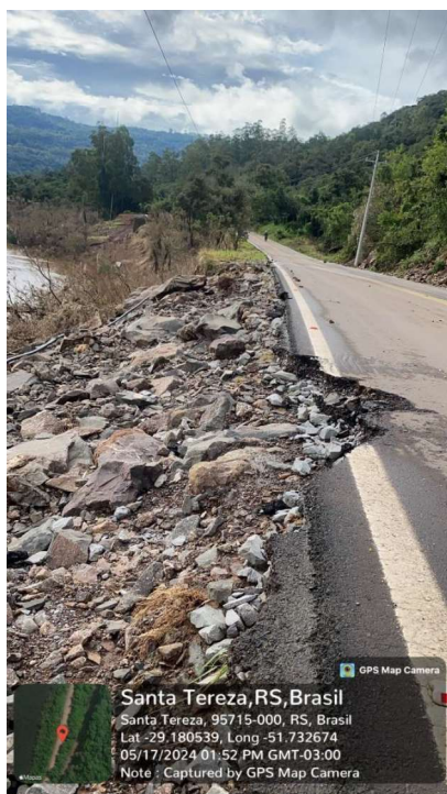
Imagem 02: destruição na margem do Rio Taquari, arrancamento da camada vegetal, bordo de pista destruído, sustentação lateral da pista comprometida, arrancamento de defensas metálicas existentes; Coordenadas: latitude -29.180539° e longitude -51.732674°; Fonte: o autor; Data da imagem: 17 de maio de 2024.
