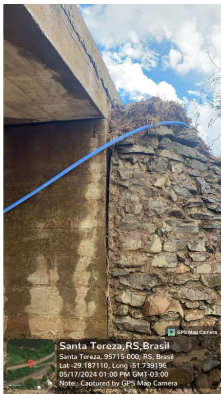
Imagem 42: rachadura no muro de contenção da cabeceira da ponte; alvenaria em pedras com avarias na parte superior; Coordenadas: latitude -29,187110° e longitude -51,739196°; Fonte: o autor; Data da imagem: 17 de maio de 2024.
