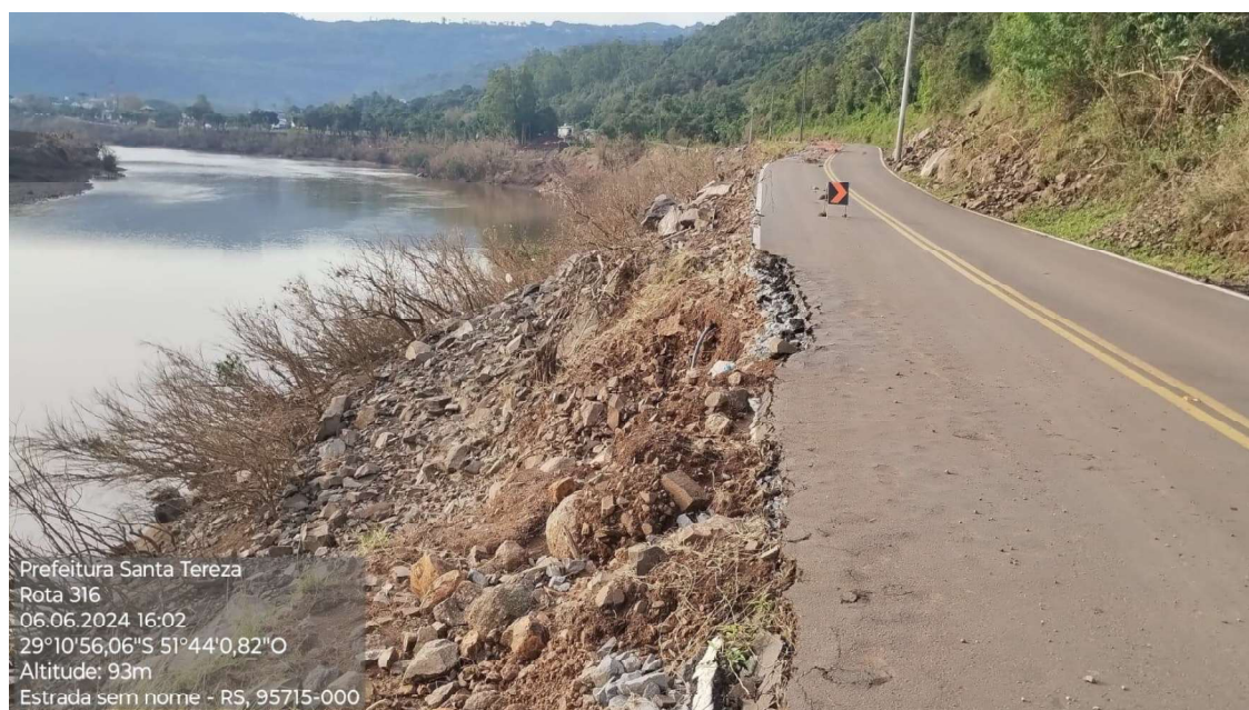
Imagem 14: destruição na margem do Rio Taquari, arrancamento da camada vegetal, parte da pista destruída, indício de base e sub-base comprometidos, sustentação lateral da pista comprometida, arrancamento de defensas metálicas existentes. Solução com contenção na lateral da via e recomposição do pavimento; Coordenadas: latitude 29°10'56,06" S e longitude 51° 44'0,82"O; Fonte: o autor; Data da imagem: 06 de junho de 2024.
