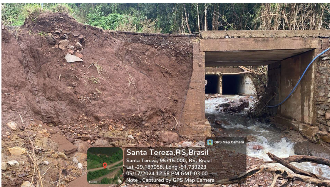
Imagem 40: ponte de pequeno porte (galeria de drenagem) com mureta de proteção arrancada, proteção de talude caída e erosão no talude; necessita de cortina de concreto armado para conter a massa de terra e dissipador de energia para diminuir a velocidade da água; Coordenadas: latitude -29,187058° e longitude -51,739223°; Fonte: o autor; Data da imagem: 17 de maio de 2024.
