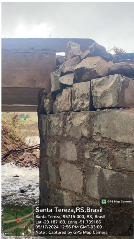
Imagem 44: rachadura e colapso na alvenaria do muro da cabeceira da ponte (galeria fluvial); Coordenadas: latitude -29,187183° e longitude -51,739186°; Fonte: o autor; Data da imagem: 17 de maio de 2024.
