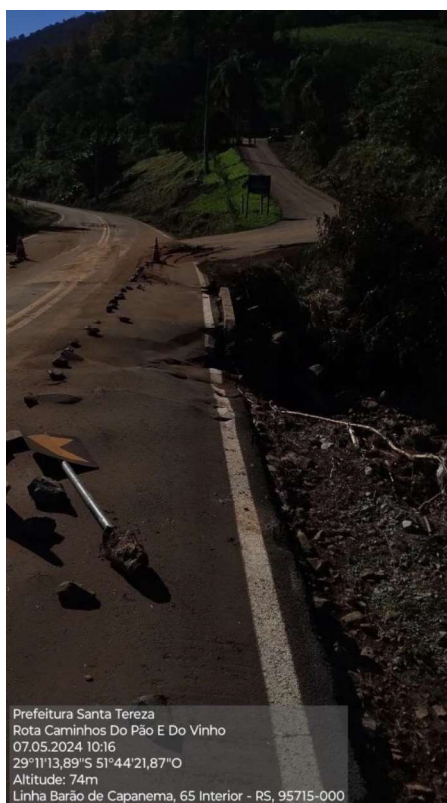
Imagem 39: pavimento avariado, desvio de tráfego delimitado por pedras por risco de colapso do pavimento sobre ponte de pequeno porte. Coordenadas: latitude 29°11'13,89"S e longitude 51°44'21,87"O; Fonte: o autor; Data da imagem: 07 de maio de 2024.
