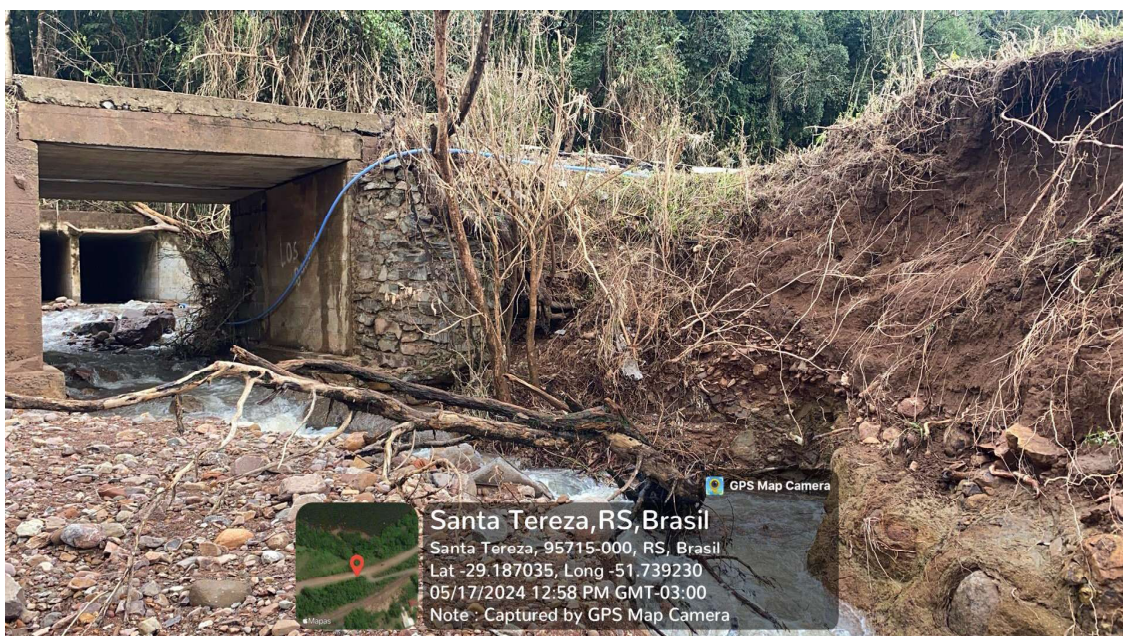
Imagem 41: erosão de talude que suporta as cargas da via, nas laterais da ponte, necessita de cortina de concreto armado para preservar as margens; Coordenadas: latitude -29,187035° e longitude -51,739230°; Fonte: o autor; Data da imagem: 17 de maio de 2024.
