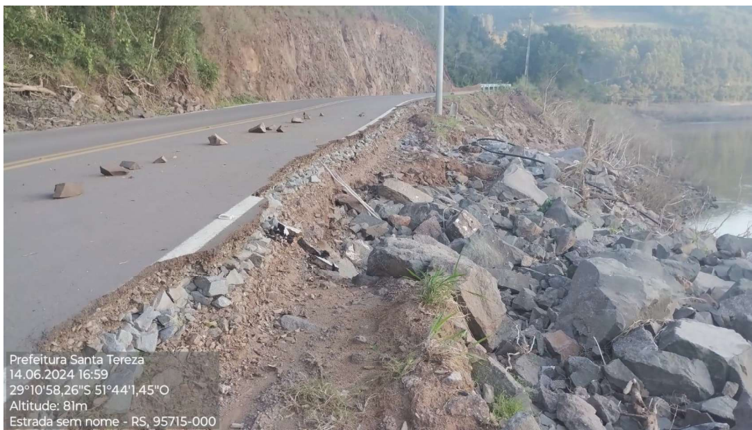
Imagem 19: destruição na margem do Rio Taquari, arrancamento da camada vegetal, parte da pista destruída, indicio de base e sub-base comprometidos, sustentação lateral da pista comprometida, arrancamento de defensas metálicas existentes. Solução com contenção na lateral e recomposição do pavimento, estabilização de parte do talude com muro de gabião; Coordenadas: latitude 29°10'58,26" S e longitude 51° 44' 1,45"O; Fonte: o autor; Data da imagem: 14 de junho de 2024.
