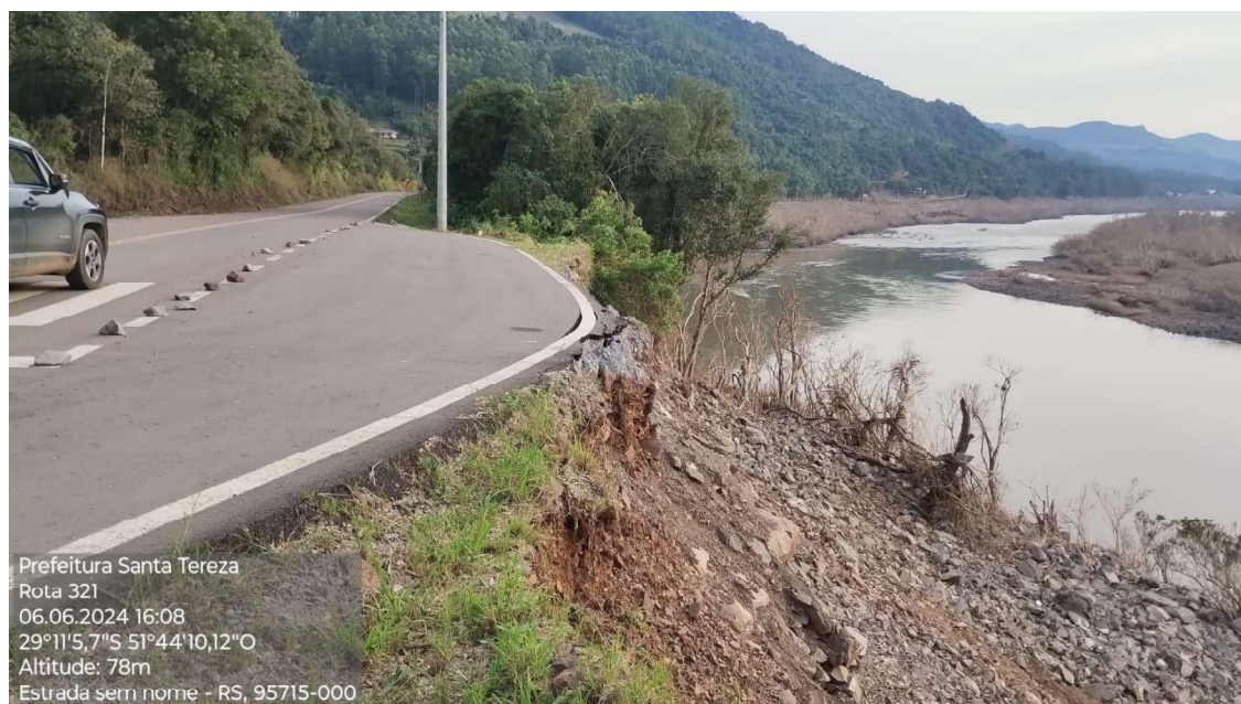
Imagem 27: destruição na margem do Rio Taquari, arrancamento da camada vegetal, parte da pista destruída, indicio de base e sub-base comprometidos e sustentação lateral da pista comprometida, solução isolar o avanço com defesa metálica no tracejado do bordo; Coordenadas: latitude 29°11'5,7" S e longitude 51° 44'10,12"O; Fonte: o autor; Data da imagem: 06 de junho de 2024.
