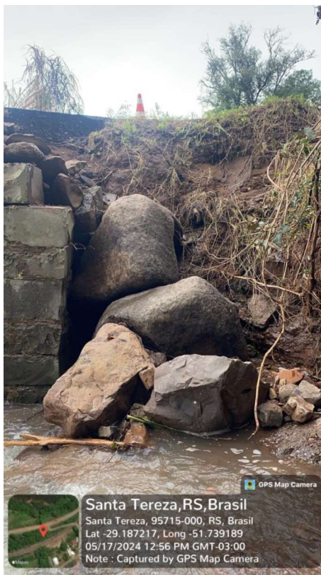
Imagem 43: colapso da lateral da ponte (galeria de drenagem) que suporta as cargas da via; Coordenadas: latitude -29,187217° e longitude -51,739189°; Fonte: o autor; Data da imagem: 17 de maio de 2024.
