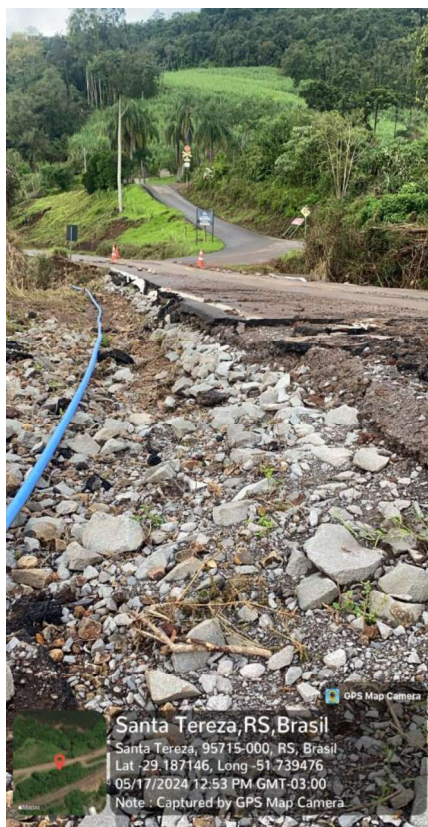
Imagem 38: erosão do talude comprometendo a pista, bordo comprometido, asfalto rachado, risco de colapso, necessário restabelecimento do pavimento; Coordenadas: latitude -29,187146° e longitude -51,739476°; Fonte: o autor; Data da imagem: 17 de maio de 2024.
