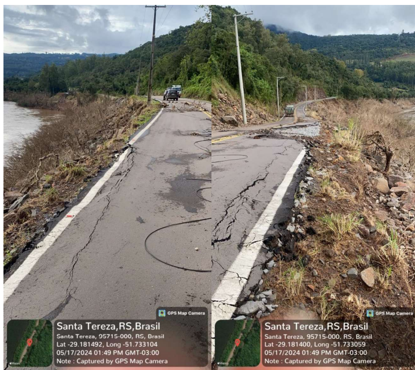
Imagem 10: pista comprometida com avarias nos bordos, solução reinstalar defensas metálicas arrancadas, construir contenção em pedra para sustentação do bordo e realizar a pavimentação do trecho da pista avariado; Coordenadas: latitude -29.181492 e longitude -51.733104; Coordenadas: latitude -29.181400 e longitude -51.733059; Fonte: o autor; Data das imagens: 17 de maio de 2024.
