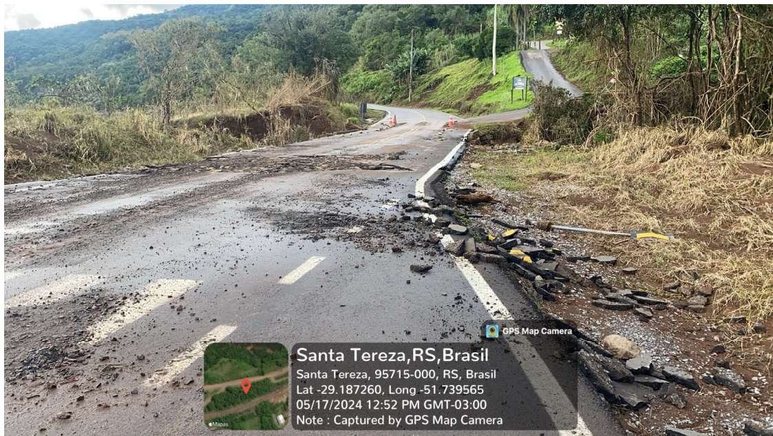
Imagem 37: parte da pista destruída; Coordenadas: latitude -29,187260° e longitude -51,739565°; Fonte: o autor; Data da imagem: 17 de maio de 2024.
