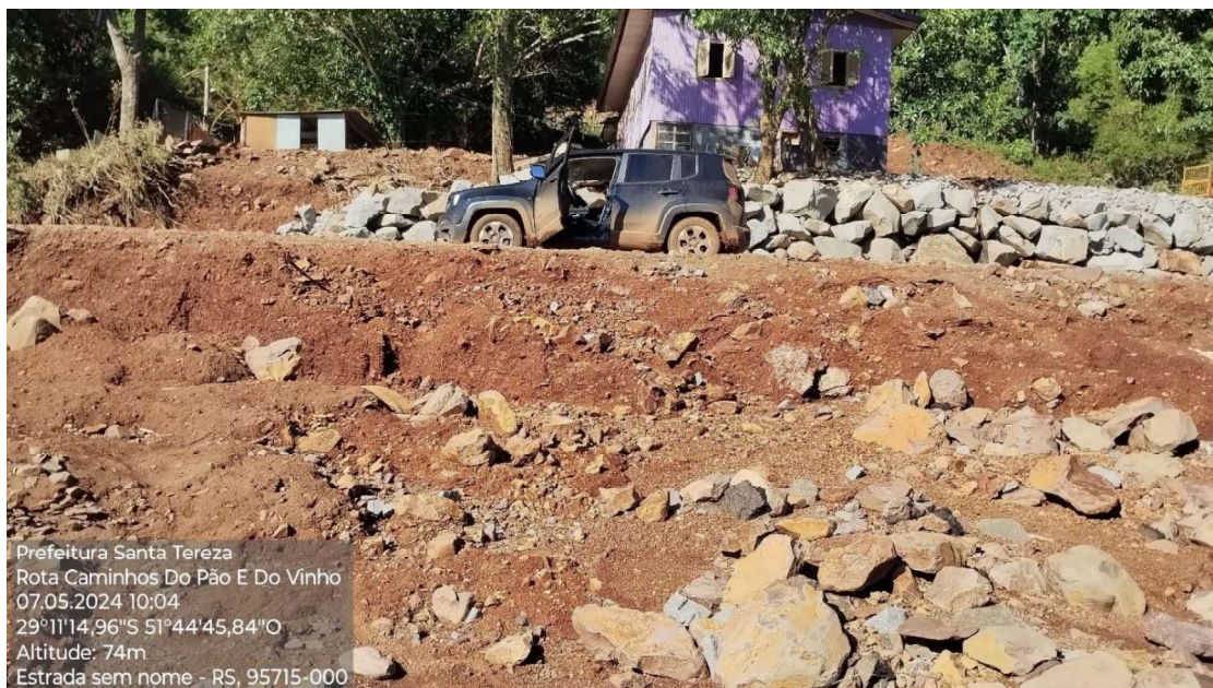
Imagem 64: talude erodido devido à força das águas ocorrida durante as inundações. Necessária a execução de enrocamento de 50 m de enrocamento com 2 m de altura e 3 m de base.
