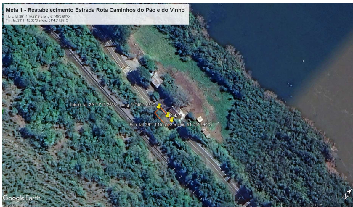
Imagem 66: localização, trecho de pavimentação atingido, com 20 metros de extensão e 7 metros de largura
